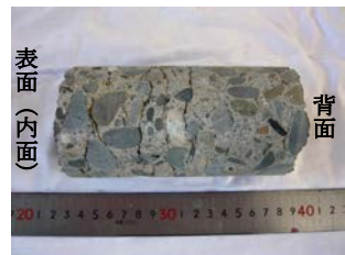
RC 開水路側壁の 層状ひび割れの発生状況
